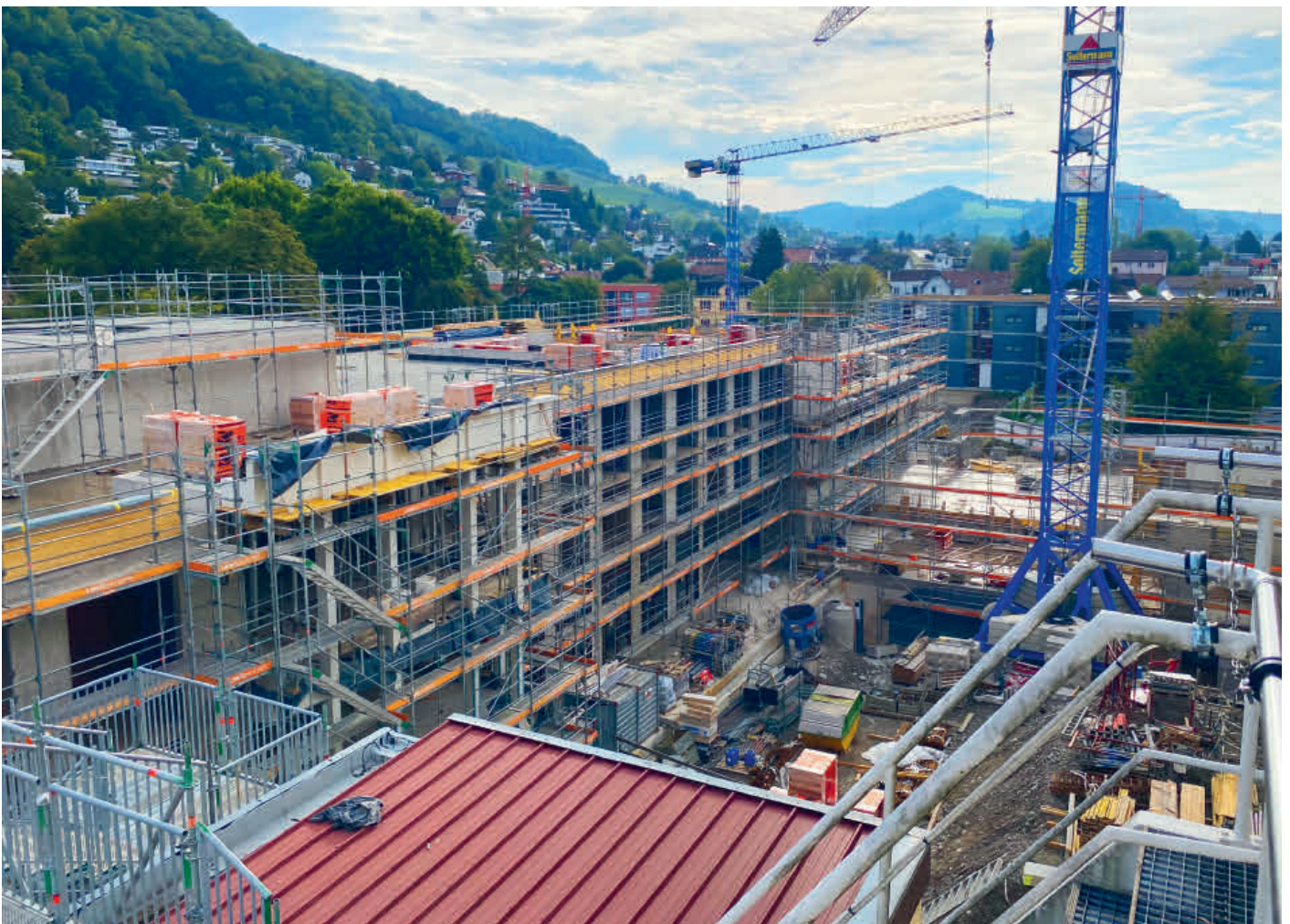
Der Neubau wächst von Tag zu Tag. Der Innenausbau hat bereits begonnen.
